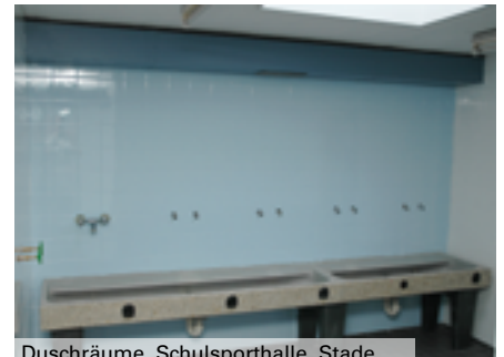
Duschräume, Schulsporthalle, Stade
