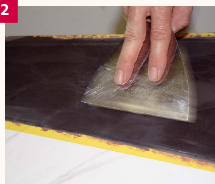
2 Mit der Edelstahlspachtel wird die gesamte Fläche zweimal mit schwarzer Spachtelmasse überzogen.
